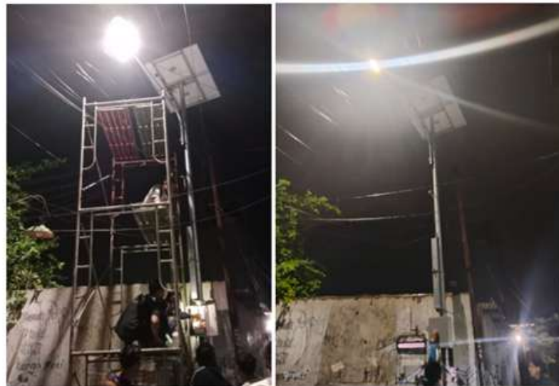
Gambar 7. PJU-Solar yang Telah Diinstal
